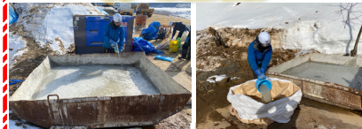
①濁水処理
